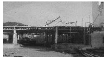
写真-2. 社長から見せていただいた建設中のバッティング練習場
